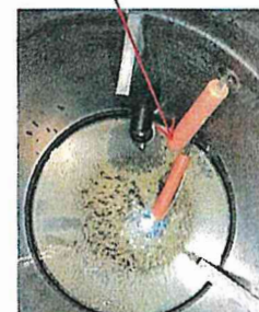
Ansicht in den Schmutzwasser-Sammelbehälter mit Schwimmern.
